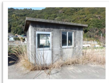
入路頭首工操作室
