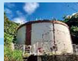
配水池(江ノ駒)
