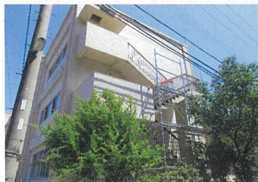
令和 2 年度 白崎小学校 校舎非常階段手すり補修 ※画像は工事中のもの
